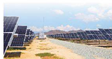
▲ Hình 9.6. Nhà máy điện Mặt Trời Thiên Tân, Ninh Thuận
