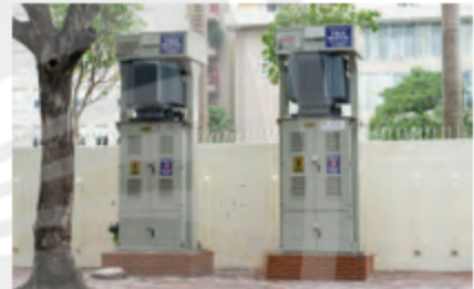
▲ Hình 2.7. Trạm biến áp đặt trên vỉa hè
