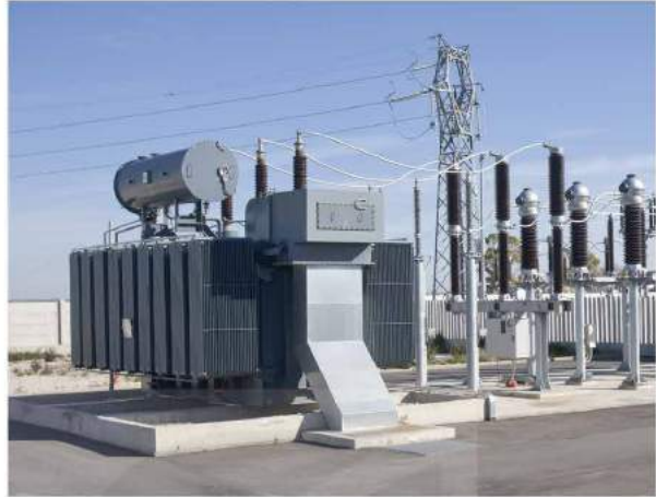
Máy biến áp trong hệ thống truyền tải điện năng
