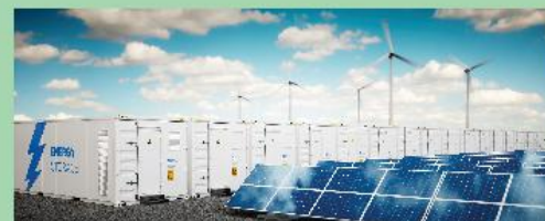
▲ Nhà máy điện sử dụng pin mặt trời
