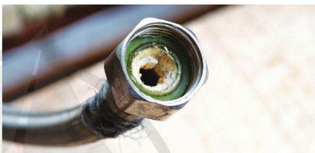
Hình 19.1. Một đoạn ống nước bị đóng cặn
