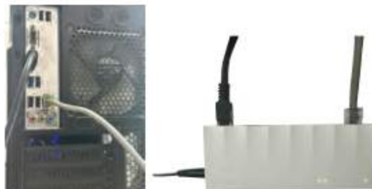
Hình 6c. Kiểm tra tín hiệu kết nối trên máy tính, modem/switch
