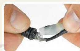
c) Dây điện bị sờn
