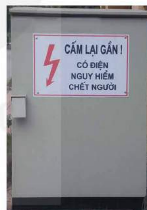
Hình 17.7. Biển cảnh báo an toàn điện
